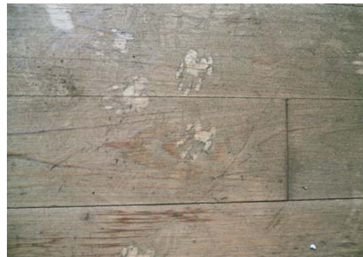
写真12 : 大部屋床のアライグマ足跡
