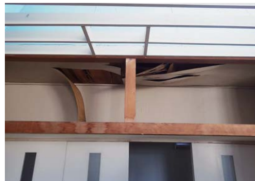
写真16 : 破られていた大部屋の押入れ天袋
