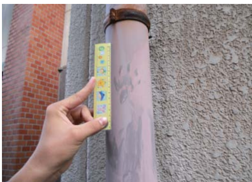
写真3：雨樋のアライグマ足跡
