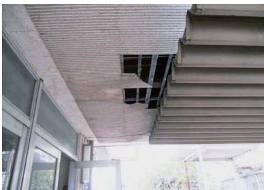
写真5：破壊された玄関前のひさし（1）
