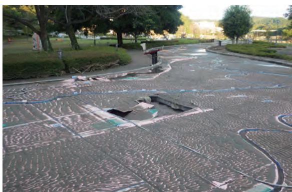
荒川大模型173に土砂が溜まり、一部破損
