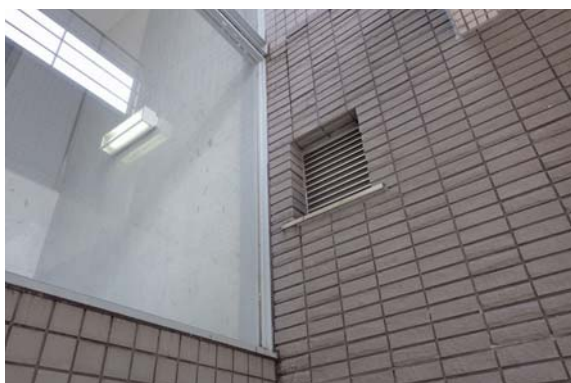
図5 A地点右側の排気口
